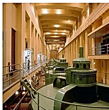
Une série d'alternateurs dans une centrale hydraulique
